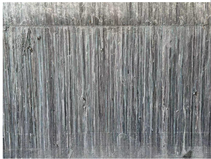
水柱沖洗後於壁面留下的痕跡
